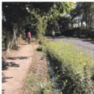
Esta acera, que ya muestra deterioro y viene de unas apartamentitos debería continuar, pero no es así.
