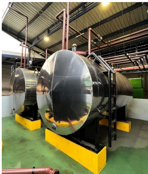
Ilustración 32. Tanques de almacenamiento de búnker caliente
