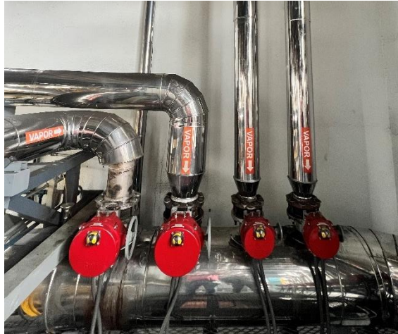
Ilustración 16. Alimentación Manifold principal planta de caderas
