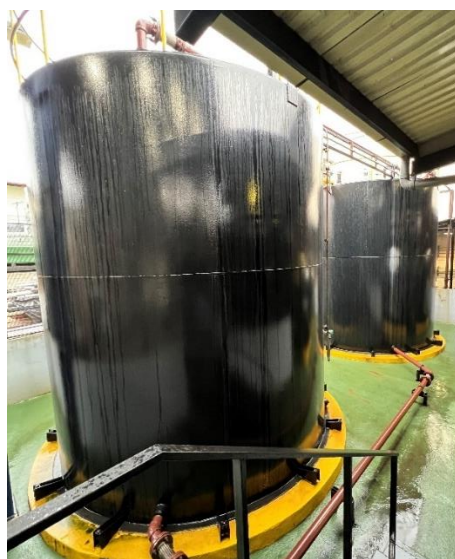
Ilustración 31. Tanques de almacenamiento de búnker frío
