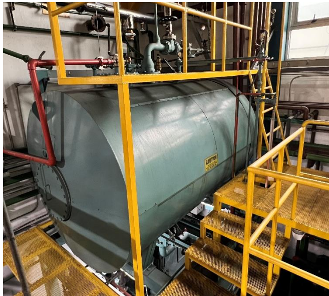
Ilustración 38. Tanque de agua ADAC.
