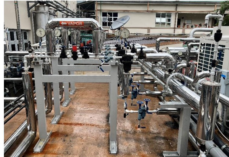
Ilustración 25. Alimentación autoclaves de centro de equipos
