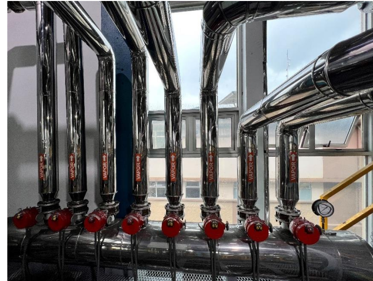
Ilustración 17. Manifold principal planta de calderas
