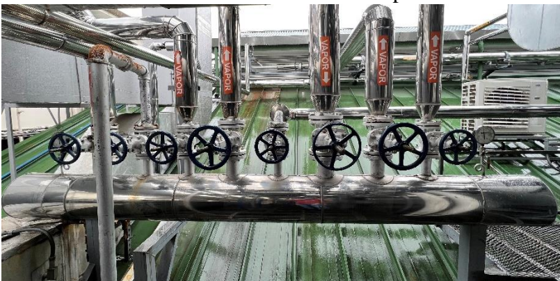
Ilustración 20. Manifold Sala de Operaciones
