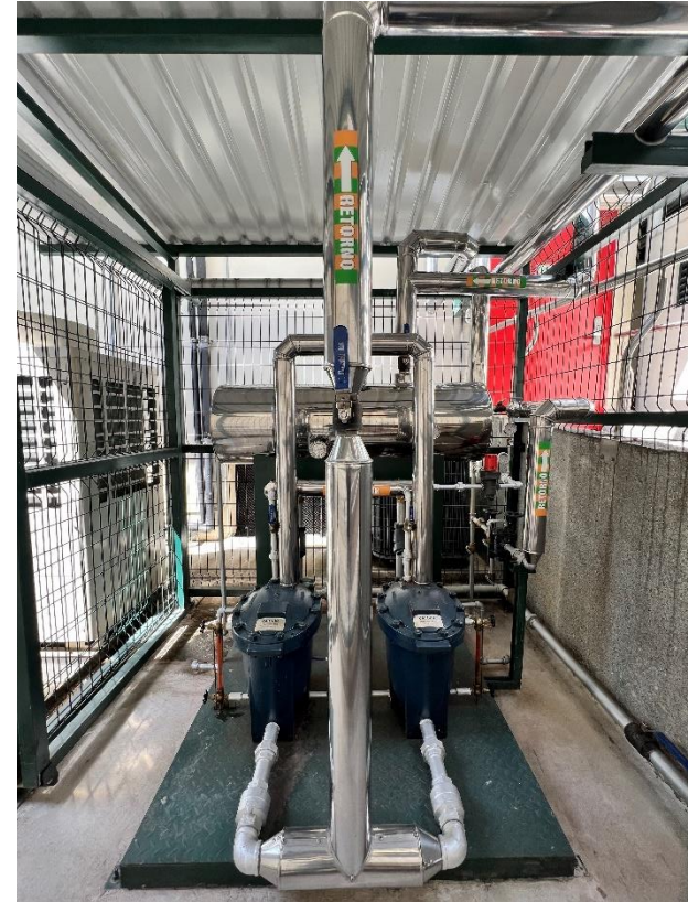
Ilustración 23. Trampas bomba Equipos de nutrición
