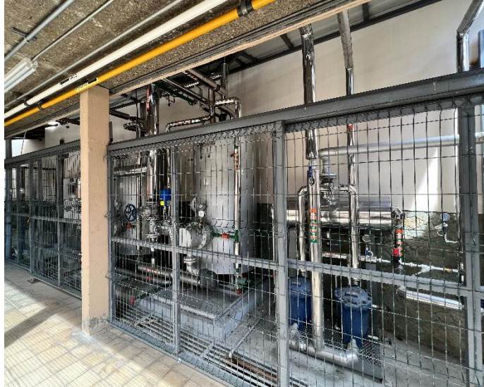
Ilustración 26. Intercambiador de calor y trampas bomba edificio de medicinas
