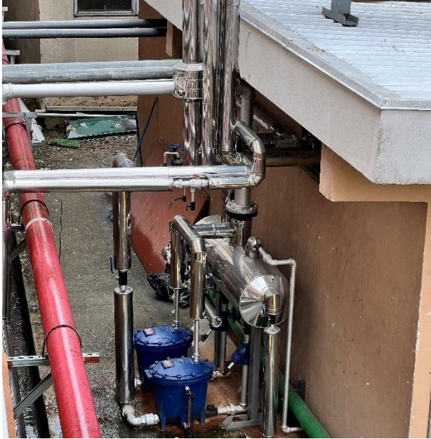
Ilustración 24. Intercambiador de calor y trampas bomba Neurocirugía.
