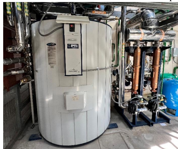
Ilustración 21. Intercambiador de calor en sala de operaciones
