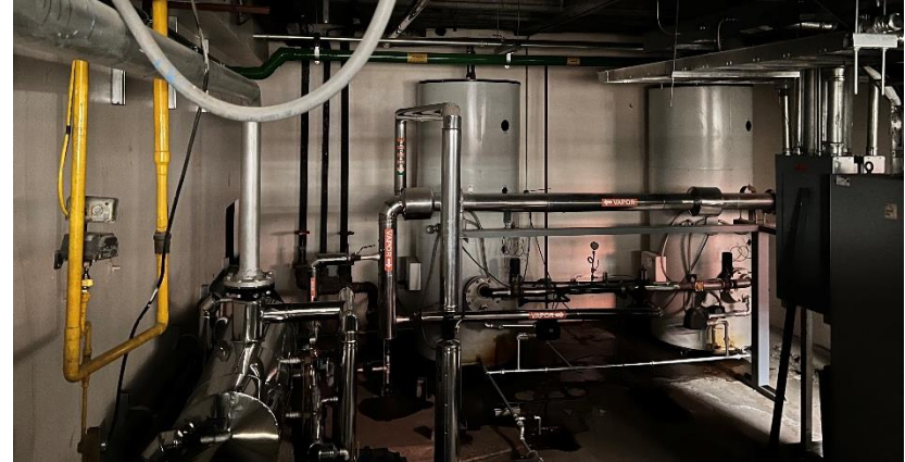
Ilustración 27. Intercambiador de calor y trampas bomba de Emergencias.
