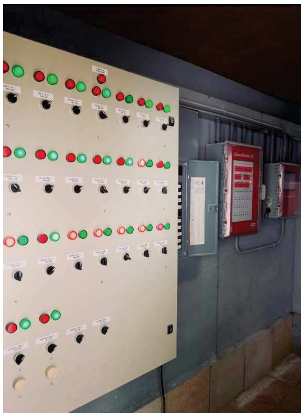
Figura 11. Panel de control automático de humedad y temperatura de la granja
