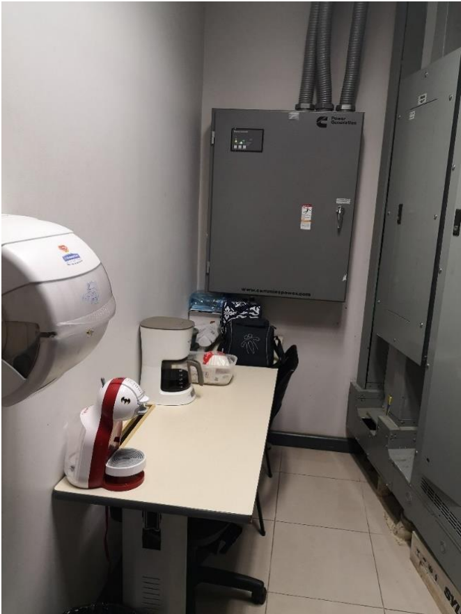
Figura 87 Objetos innecesarios en cuartos eléctricos
