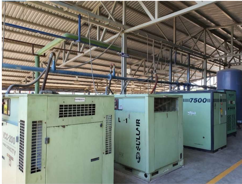
Imagen 2 Cuarto de compresores de extrusión
