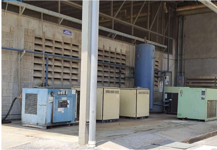
Imagen 1 Cuarto de Compresores de Inyección
