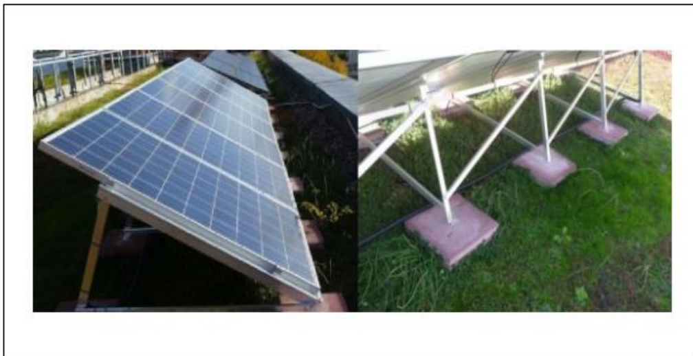
Ilustración 30. Arreglo fotovoltaico de 1000wp en un techo verde plano. Izquierda: Tenga en cuenta que existe suficiente espacio en frente de los módulos fotovoltaicos para evitar el sombreado ocasionado por la pared baja. Derecha: tenga en cuenta que la estructura de montaje se sujeta por el lado de las losas de hormigón y no se han hecho fijaciones en techo.
