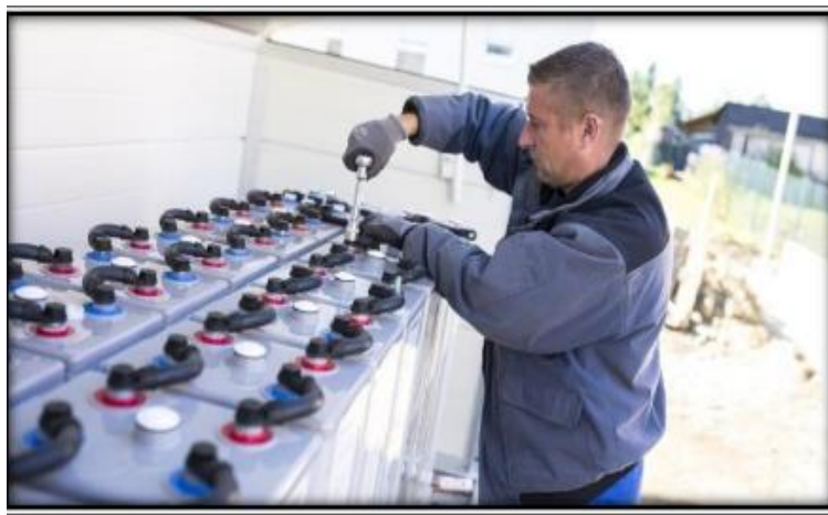
Ilustración 20. Instalación de un banco de baterías de gran tamaño, el trabajo puede ser peligroso y los técnicos deben estar debidamente capacitados.
