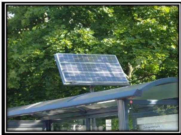
Ilustración 29. Módulos sombreados en un montaje en poste. La potencia de salida será muy baja, una falla de instalación común.
