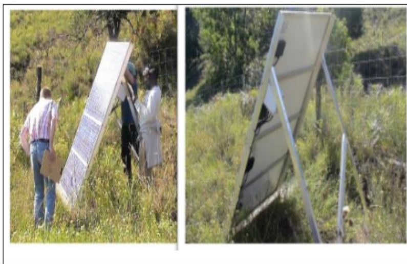
Ilustración 26. Estructura de montaje en suelo, Francia. Tenga en cuenta que el módulo del fondo está muy cerca del suelo y podría verse sombreado por el crecimiento de la hierba. El material de la estructura es de aluminio.
