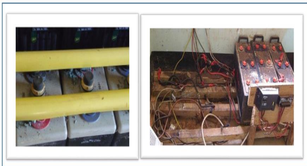
Ilustración 38. Izquierda: Terminales de baterías corroídas. Daños por corrosión baterías de 2V ciclo profundo. Derecha: sistema totalmente abandonado.
