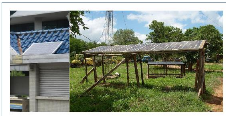
Ilustración 31. Izquierda: Módulo fotovoltaico mal montado en una parada de autobús, simplemente fue puesto en el techo y no fue fijado en una estructura de soporte adecuada. Un fuerte viento podría despegarlo fácilmente y causar lesiones graves. Derecha: Módulos montados en un marco de madera mal construido. La madera no ha sido tratada, por lo que está pudriendo y la estructura está a punto de caer.
