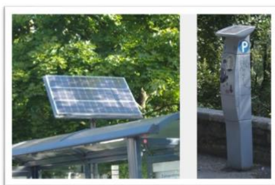
Ilustración 2.. (Izquierda) Sistema Fotovoltaico fuera de red en una parada de autobús en Berlín. (Derecha) Parquímetro funcionando con FV, Roma, Italia
