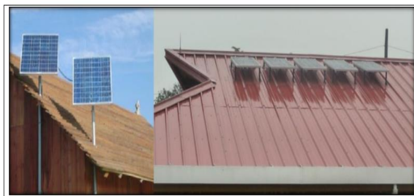
Ilustración 25. . Módulos montados en poste y en techo. Izquierda: Módulos fotovoltaicos montados en poste, Gales Reino Unido. Derecha: Módulos solares montados en el techo del centro de capacitación de la Universidad EARTH-Costa Rica. Tenga en cuenta que hay un espacio de aire entre los módulos y el techo de metal, material de la estructura de montaje es hierro dulce pintado.
