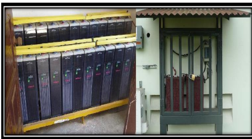
Ilustración 36. . Ejemplos de buenas prácticas. Izquierda: Baterías de plomo-ácido de ciclo profundo de 2V en una sala de baterías. Derecha: Baterías instaladas en una caja hecha a la medida.
