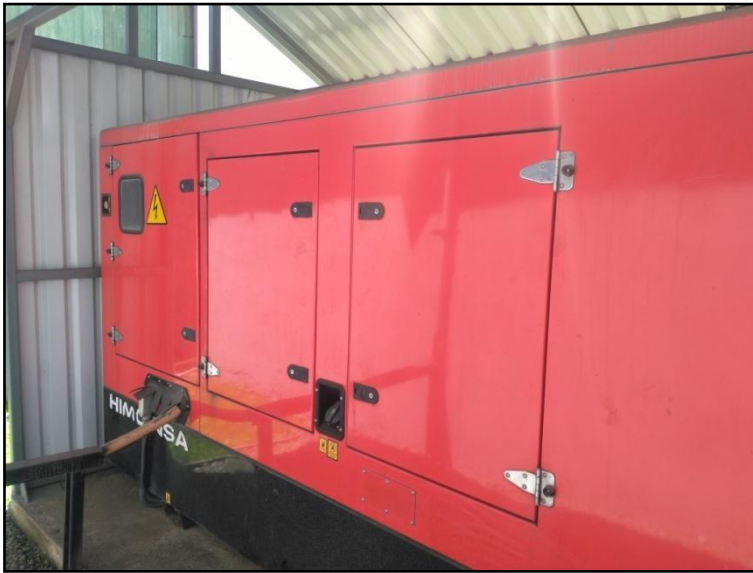
Ilustración 17 Planta de emergencia estación de bombeo numero uno.
