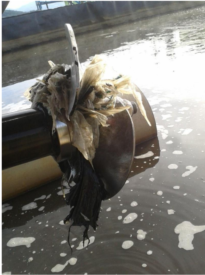
Ilustración 21 Cilindro de mezclados obstruido.
