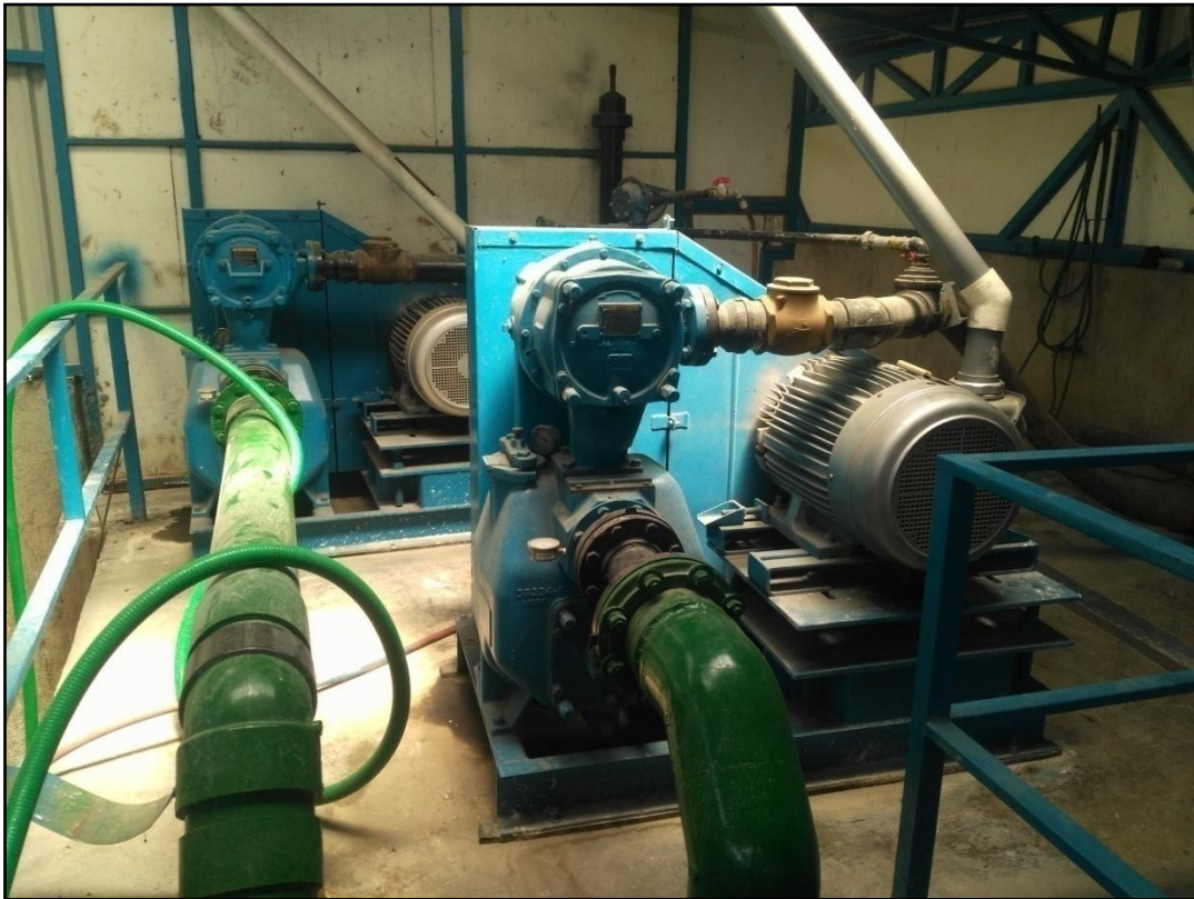
Ilustración 14 Estación de bombeo uno.
