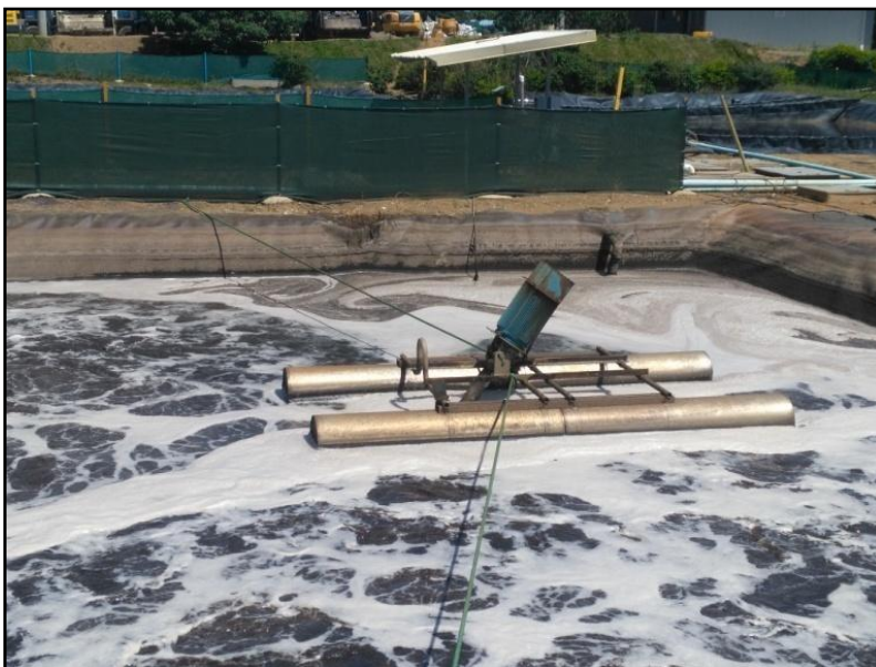
Ilustración 19 Aireador en funcionamiento.
