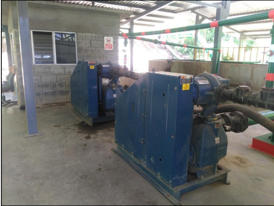
Ilustración 15 Estación de bombeo dos.
