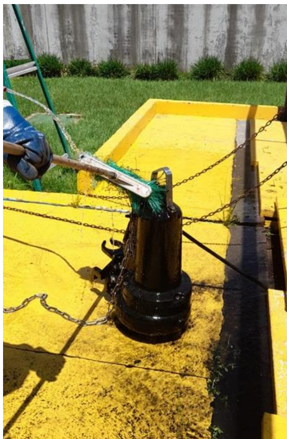
Figura 42. Figura Desarrollo 4. Equipos de bombeo presentes en el tanque de vaciados.
