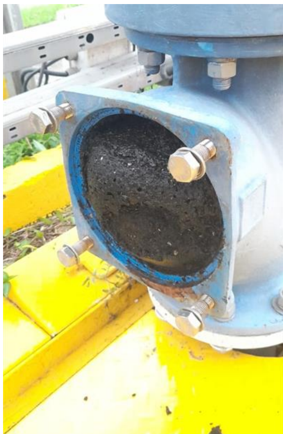
Figura 41. Figura Desarrollo 3. Obstrucción en válvulas antirretorno (Check) por excesos de arenas en tanque de vaciados.
