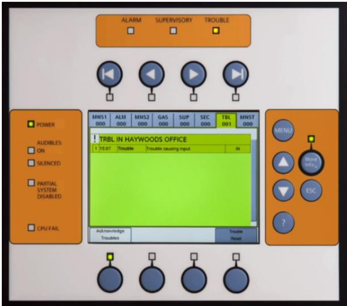
Figura 59: Panel de detección de incendio panel normal
