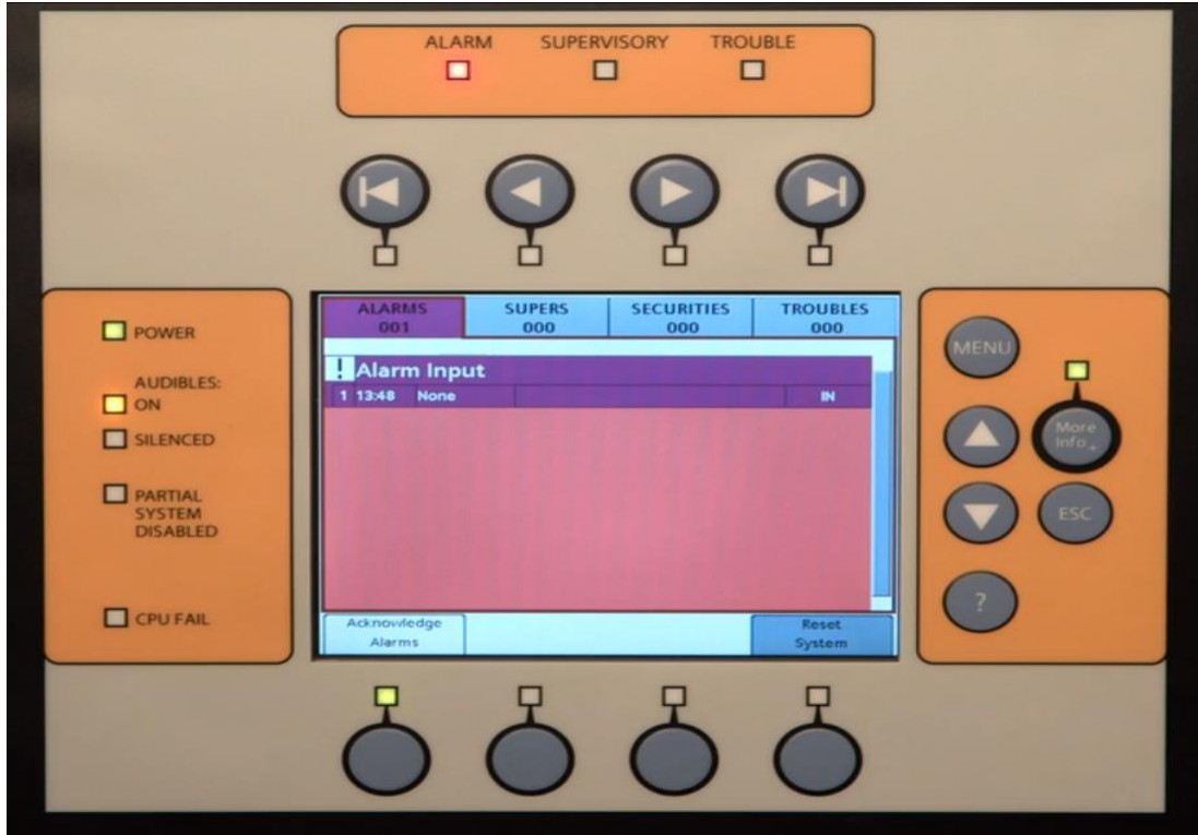
Figura 58:: Panel de detección de incendio panel normal
