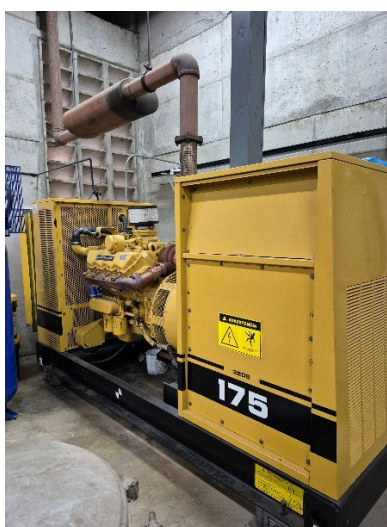
Ilustración 15 Planta generadora, vista frontal
