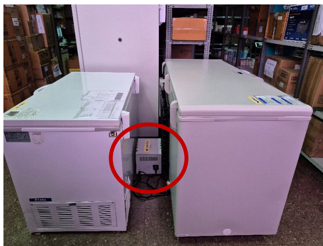
Ilustración 21 Conexión equipo médico a UPS
