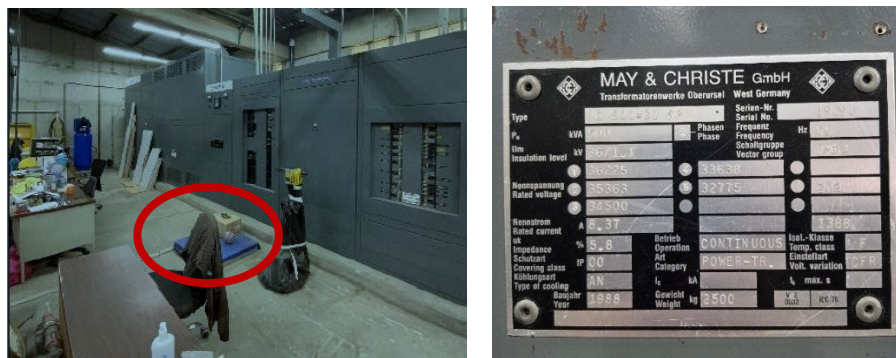
Ilustración 22. Ubicación de la subestación eléctrica
