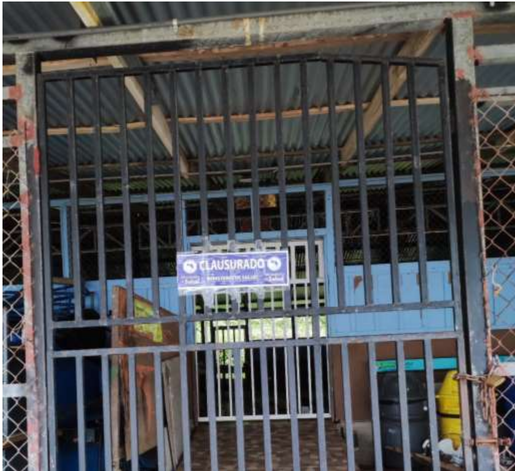
Imagen 31: Liceo Rural de Bahía Drake, Clausurado por deterioro en Instalaciones
