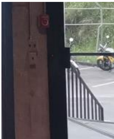
Figura 17. Interruptores de Luminarias
