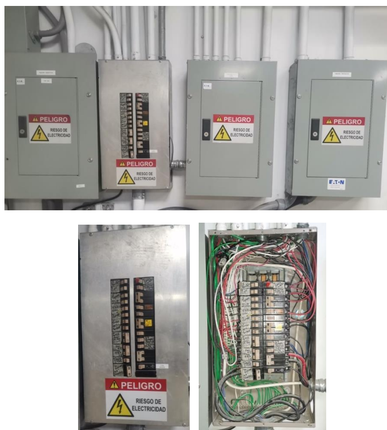
Figura 21. Tablero de distribución eléctrica
