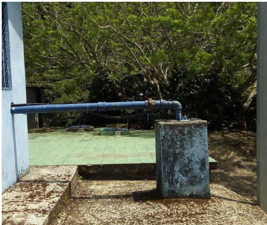
Figura 20. Ubicación de bomba sumergible Fuente: Propia
