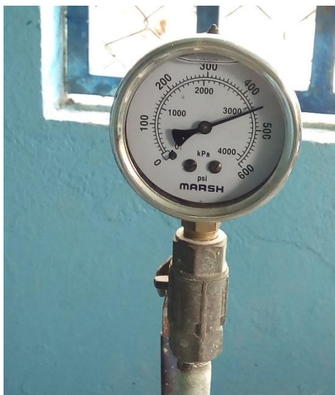
Figura 15. Manómetro a la salida de la bomba Fuente: ASADA Zapotal de Tarrazú
