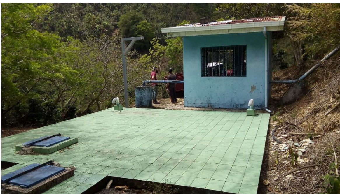
Figura 19. Tanque de Captación de Naciente Fuente: Propia
