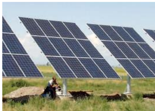
Figura 27. Soporte de paneles solares Fuente: http://preformed.com/solar
