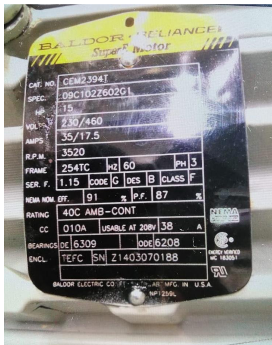
Figura 52: Fotografía de la placa del motor eléctrico
