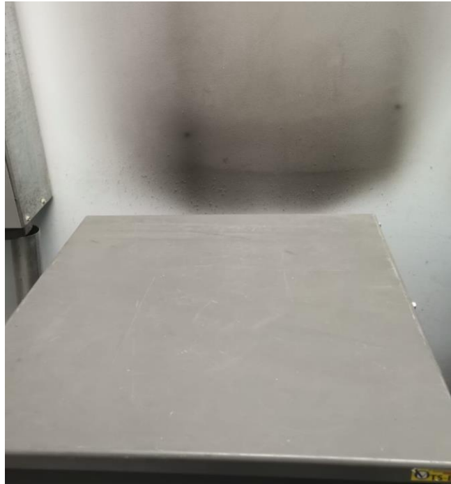
Figura 37: Evidencia calentamiento en pared
