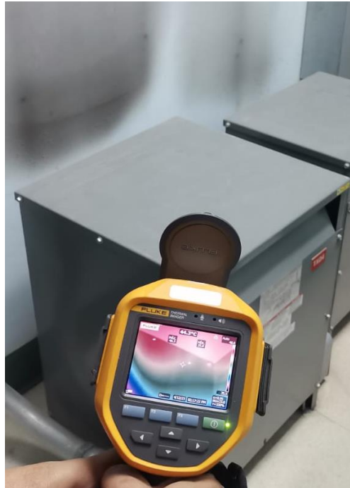
Figura 38: Toma de termografía externa Transformador TXD4
