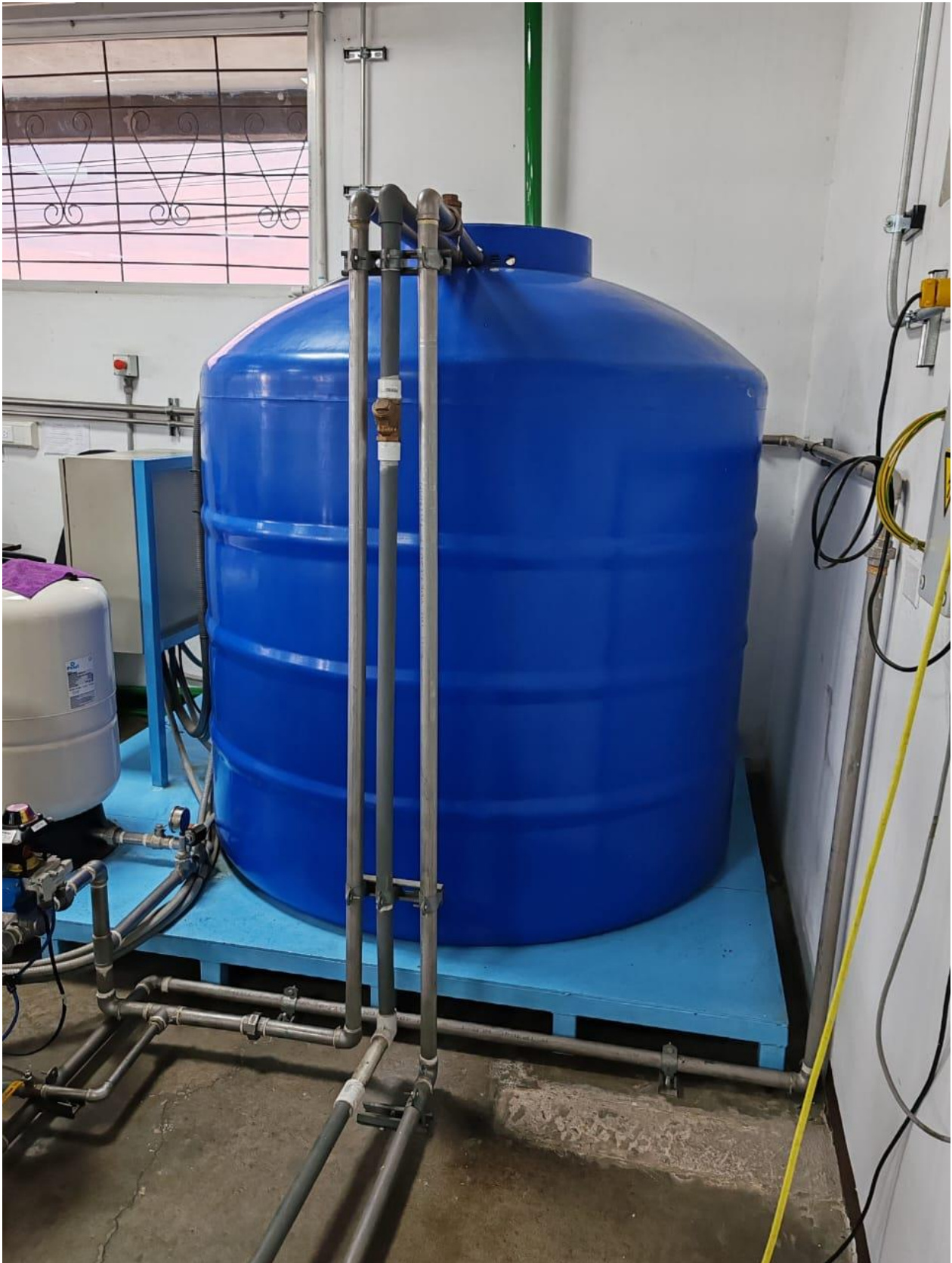
Anexó 7. Tanque principal de 2500l.
