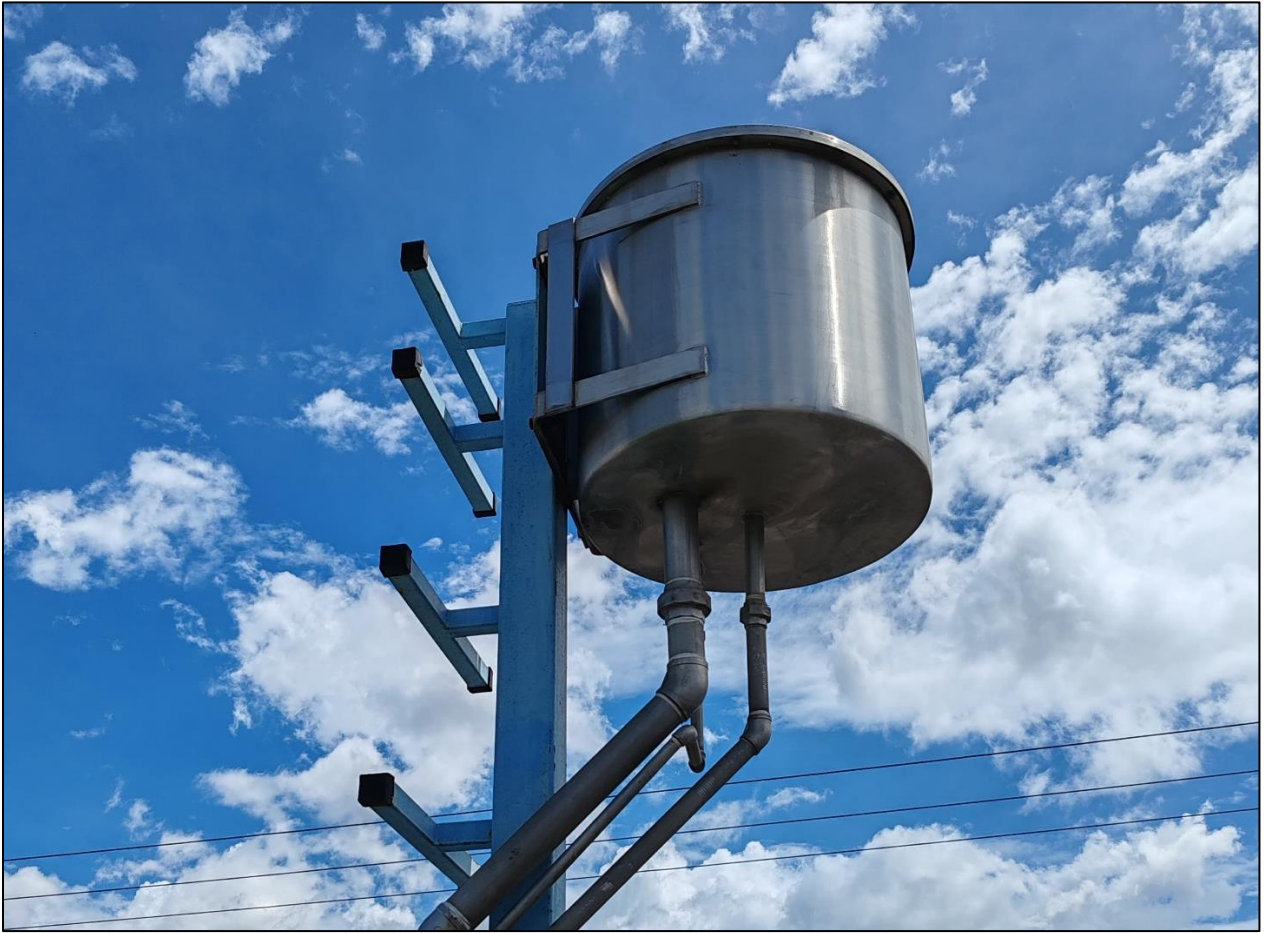
Anexó 2. Tanque elevado para caudales por gravedad.
