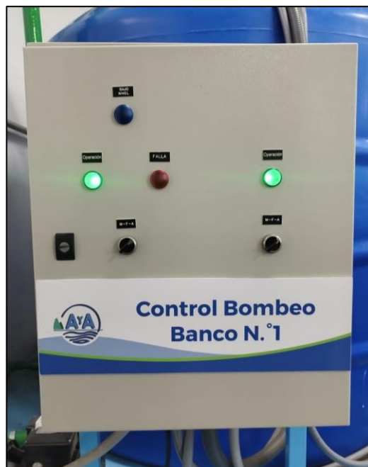
Figura 33. Panel de potencia de las bombas.
