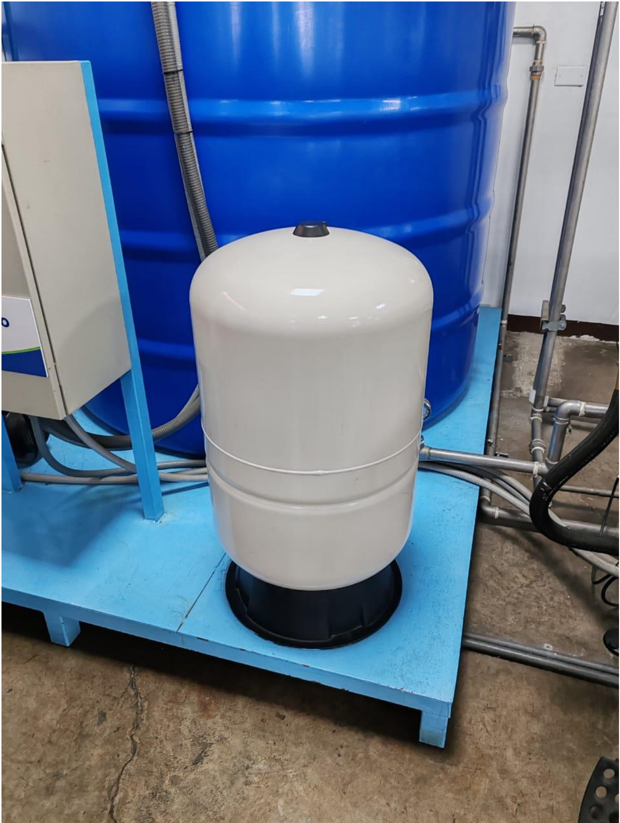
Anexó 6. Tanque hidroneumático.
