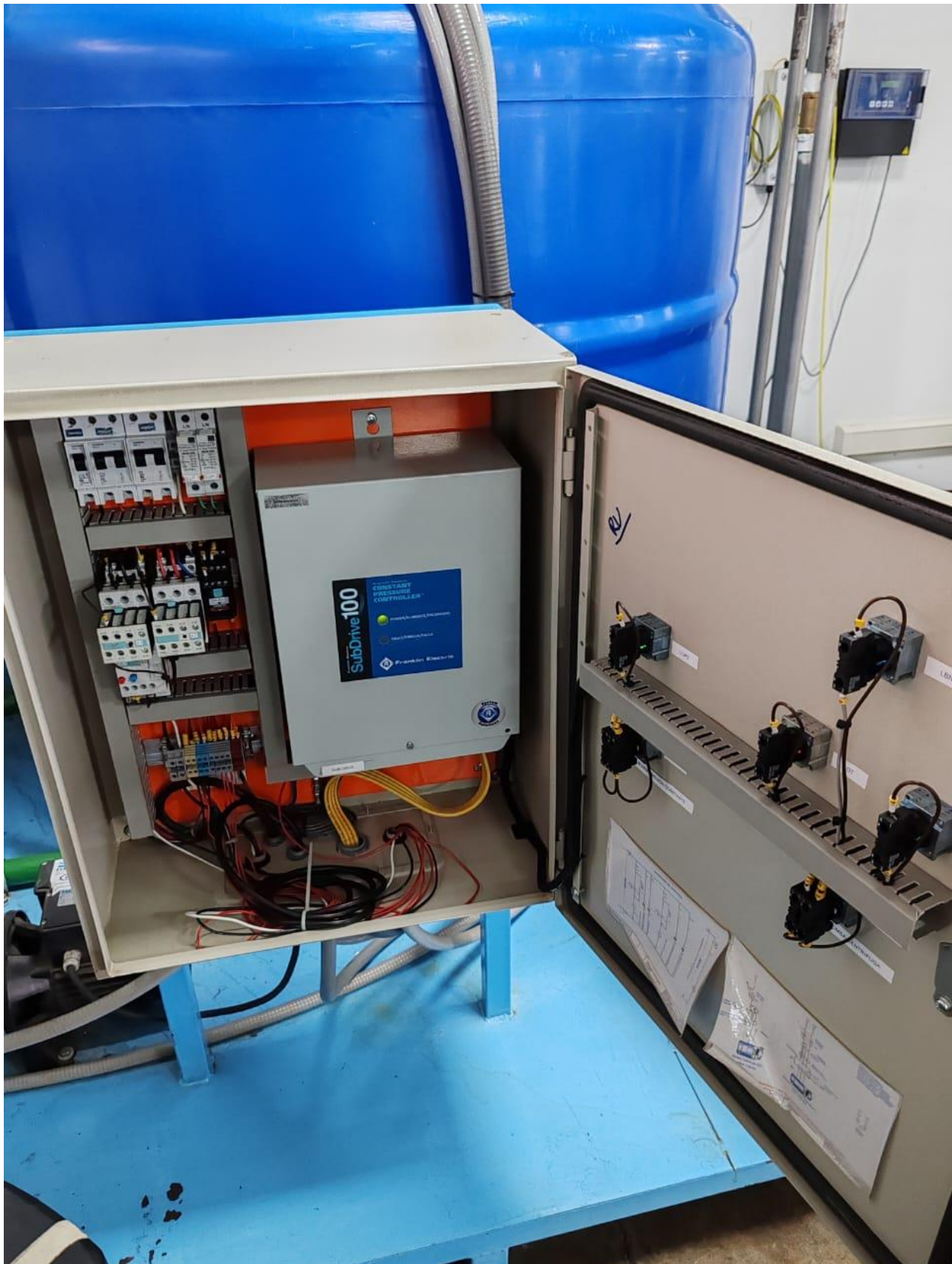
Anexo 5. Panel de potencia.
