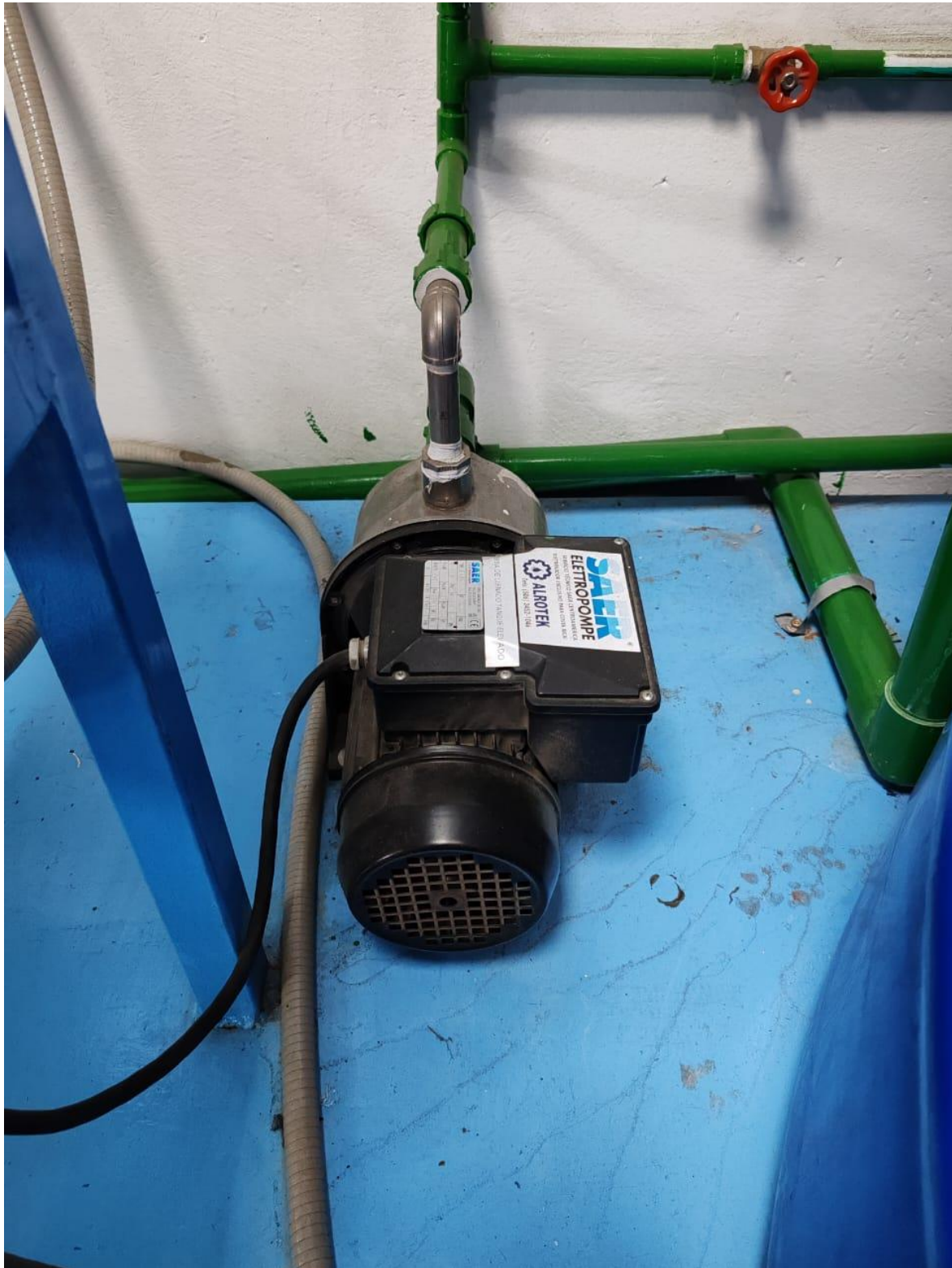
Anexó 4. Bomba de recirculación.
