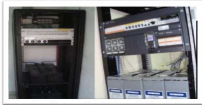
Figura 2.9: Equipos Rectificador, de control y baterías de 2power plant
