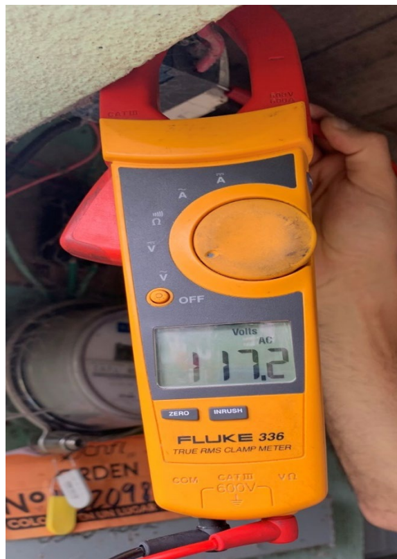
Figura 18 Consumo tensión eléctrica de la bomba
