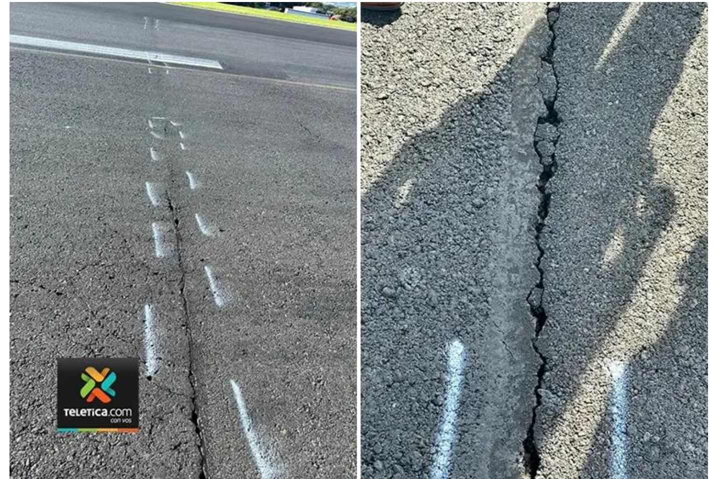
Figura 45 – 3. CAPÍTULO 2: MARCO TEÓRICO – Grieta de 76 metros encontrada en la pista del Juan Santamaría. Imagen sacada de la página de Teletica.com
