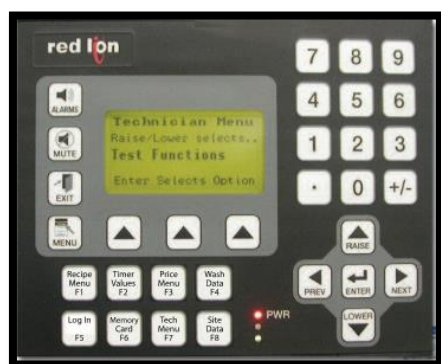
Figura 61 Panel de interconexión del Puente de lavado Water Wizard 2.0
