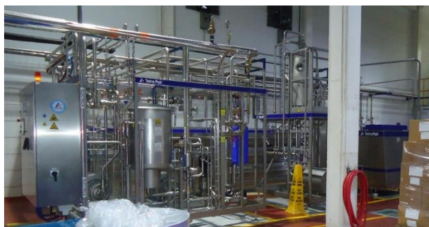
Figura 5 Pasteurizador de línea 10 y línea 11
