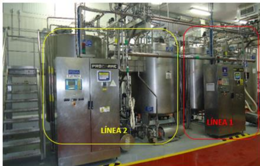
Figura 2 Tanques de línea 1 y línea 2
