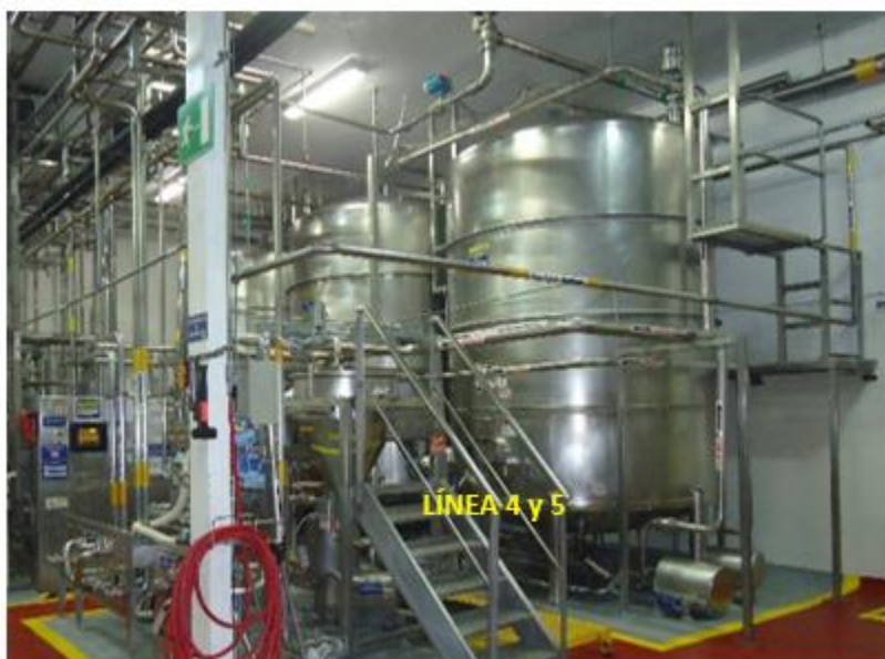
Figura 3 Tanques de línea 4 y línea 5
