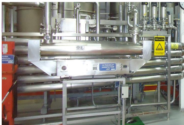
Figura 4 Pasteurizador de línea 4 y línea 5
