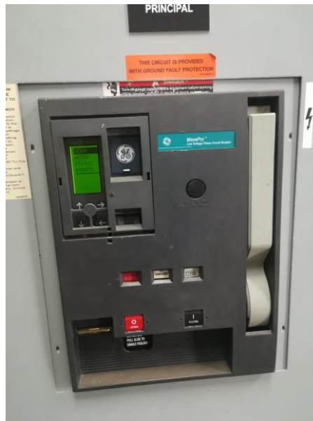
Figura 36 Disyuntor Principal de la acometida.
