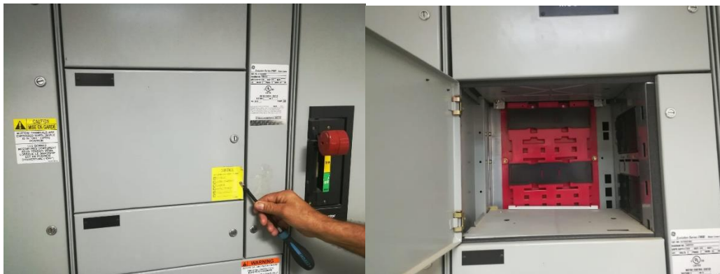
Figura 37 Espacio para la instalación de interruptores de los inversores.
