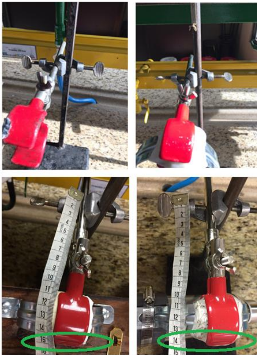
Figura 30. Representación de la correcta posición de las prensas en su respectivo poste metálico.
