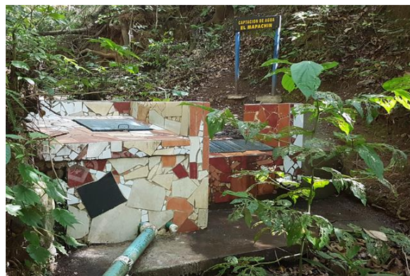
Figura 22. Captación toma superficial Macpachin
