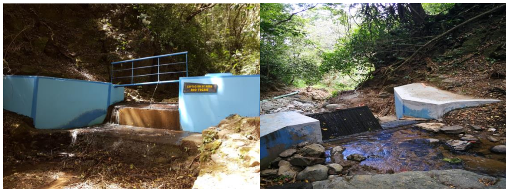
Figura 12. Captación toma superficial Río Tigre.
