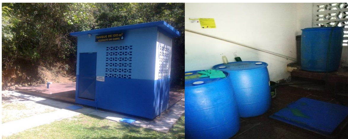
Figura 27. Tanque de almacenamiento y sistema de desinfección
