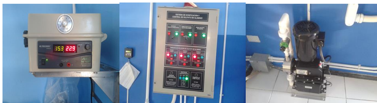
Figura 16, Sistema de desinfección (dosificar de hipoclorito de sodio).
