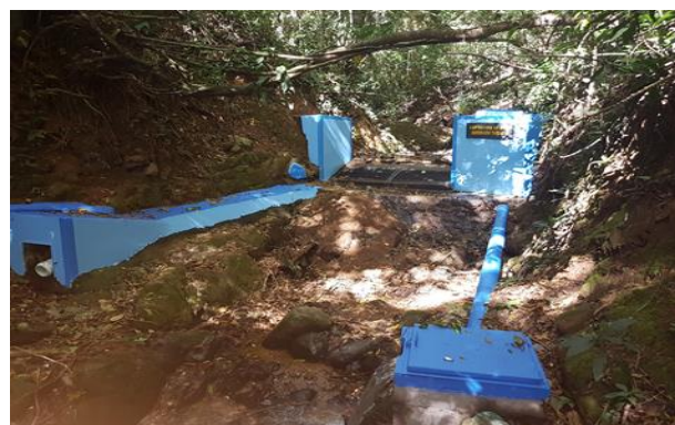
Figura 23. Captación toma superficial Quebrada Tarbaca
