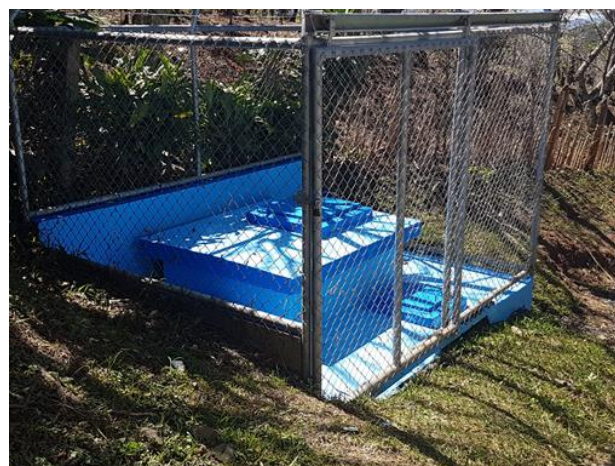
Figura 18. Tanque Quebrada Gradiente
