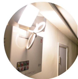
Figura C5.62 Iluminación. Fuente Dielco
