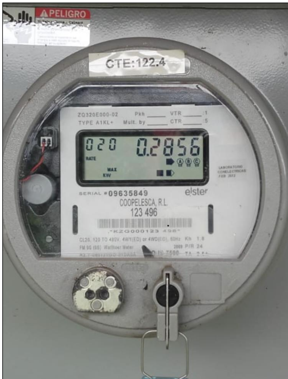
Figura 1. 24 Imagen del medidor de la planta
