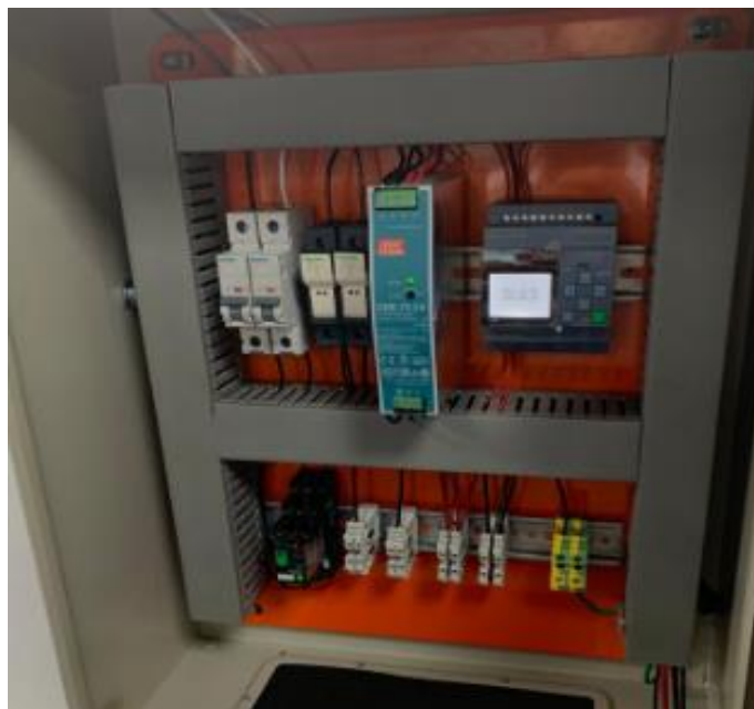
Ilustración 17:Panel de control de válvula neumática
