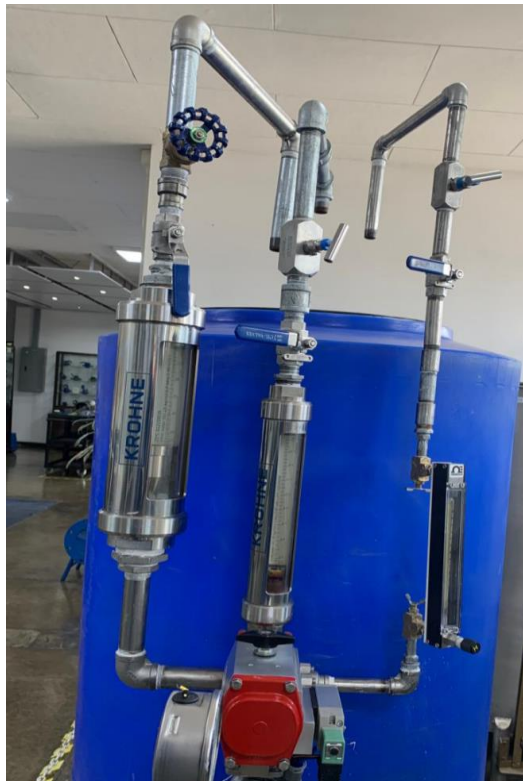
Ilustración 7: Rotámetros en ramales de banco#2
