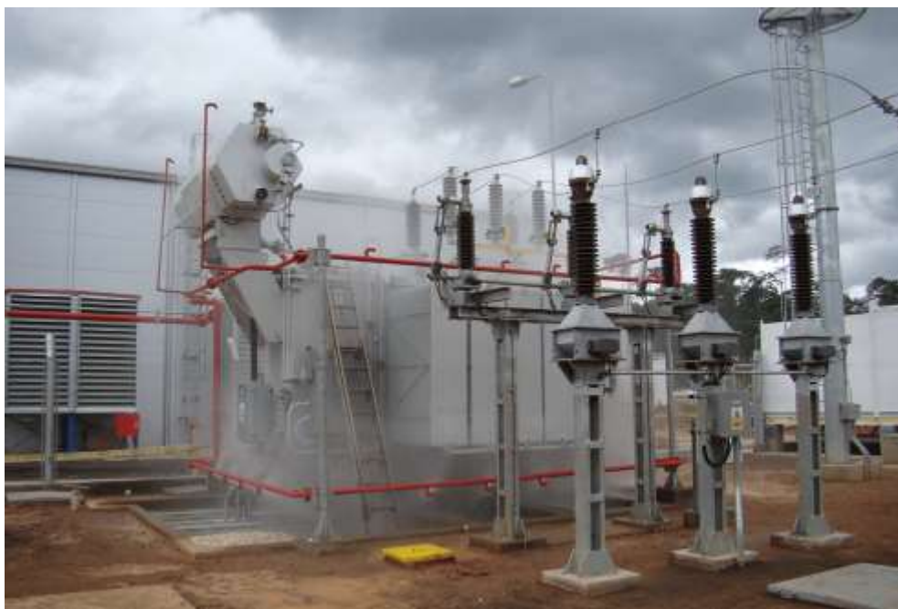
Figura 7 Ejemplo de un sistema de agua pulverizada. Descarga en una subestación eléctrica (Bracho, 2012)
