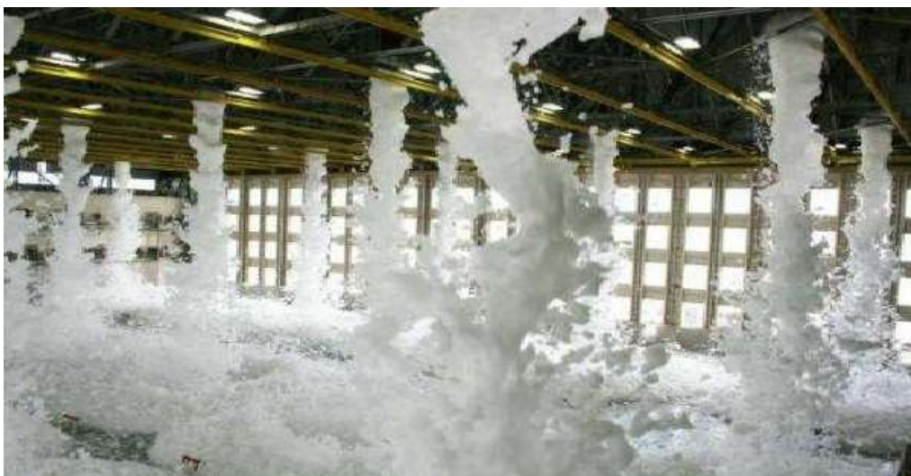
Figura 8 Ejemplo de una descarga de espuma para extinción de fuegos (PINZÓN, 2017)
