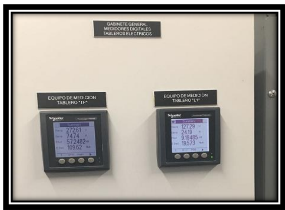
Figura 14 Paneles de mediciones Fuente: Circuito S.A. México
