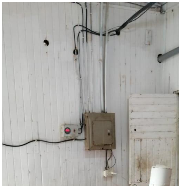
Figura 14. Centro de carga.
