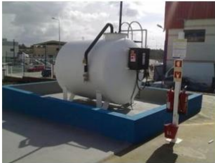
Figura 14. Tanque de combustible superficial no confinado. Mecaluxlogismarket (2015).
