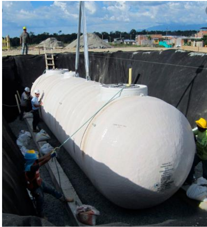
Figura 9. Tanque de Combustible de Pared Sencilla. Fluid Containment. (2017).
