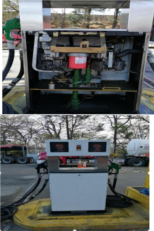
Figura 3. Dispensador de combustible de GASH. Elaboración propia.
