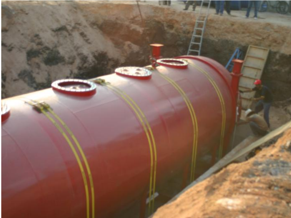
Figura 13. Tanque de Combustible de Subterráneo. Tanques tipsa (2015).
