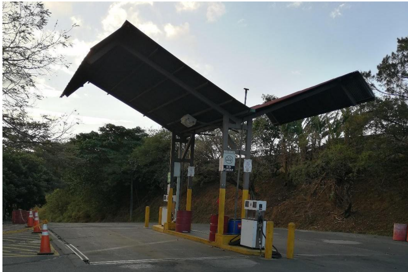
Figura 17. Área de dispensa de combustible. Elaboración propia.
