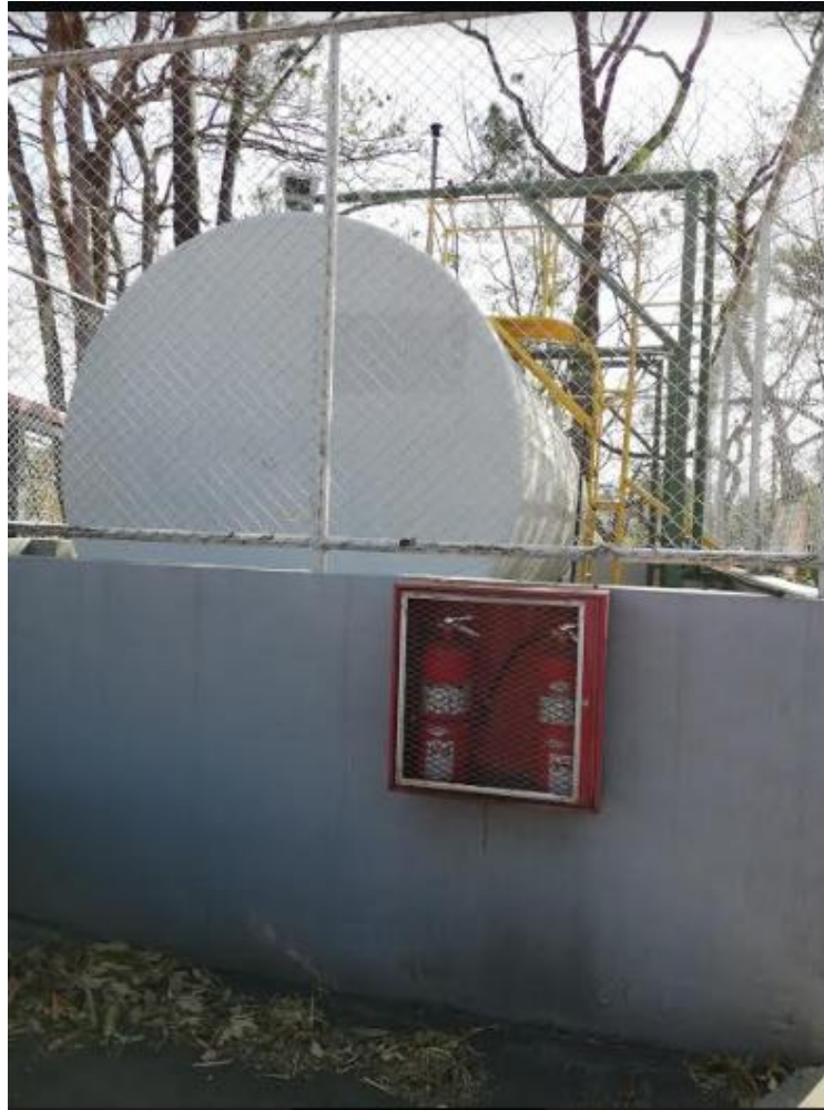
Figura 11. Tanque de Combustible de Confinado. Elaboración propia.
