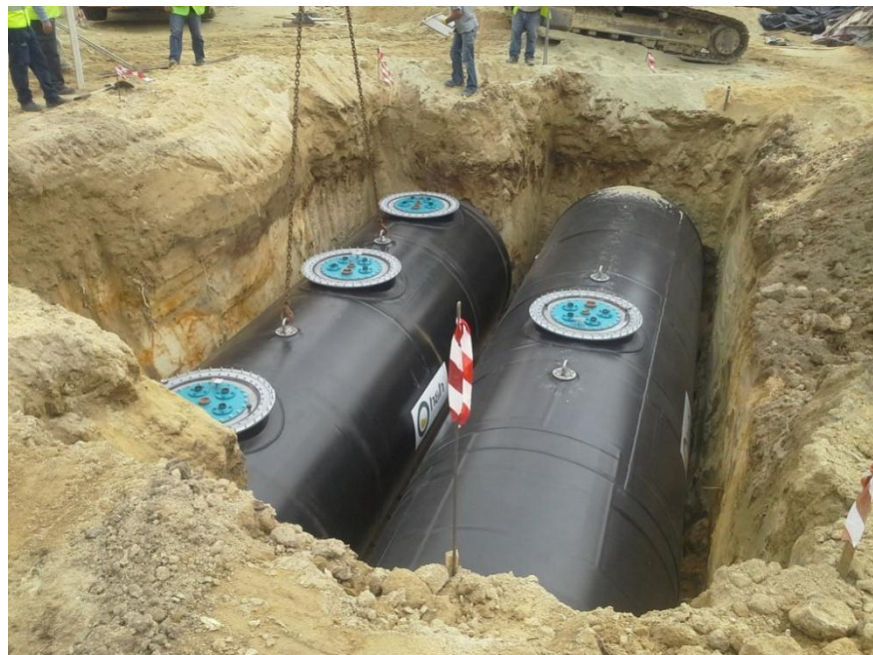
Figura 10. Tanque de Combustible de Pared Doble. Henrique y Henríquez S.A (2015).
