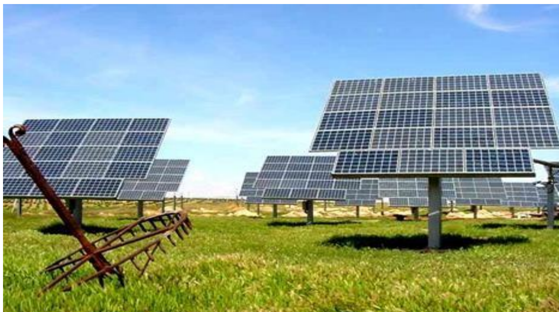
Figura 2.16 Sistema de paneles solares
