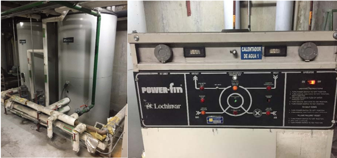
Figura A.1 Tanques de almacenamiento y calentador a Gas de Torre Sur
