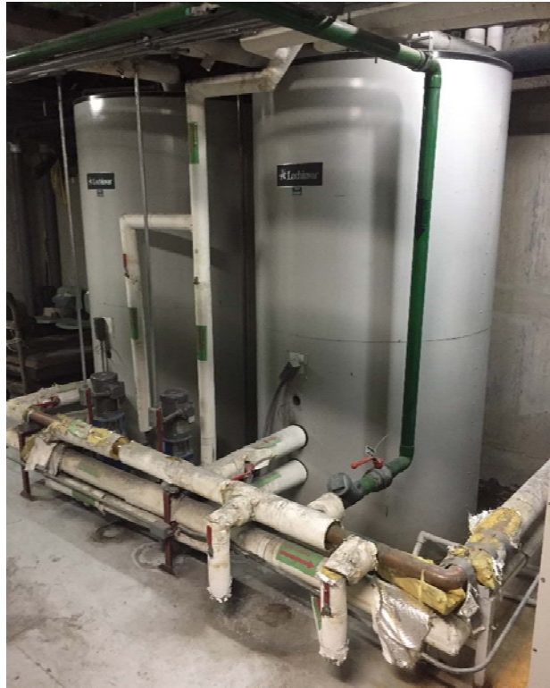
Figura 1.4 Sistema de calentamiento de agua torre sur.
