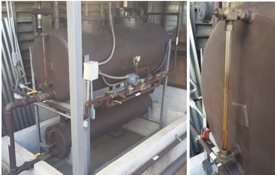
Figura 4.1 Visor de nivel en tanque de almacenamiento de diésel.
