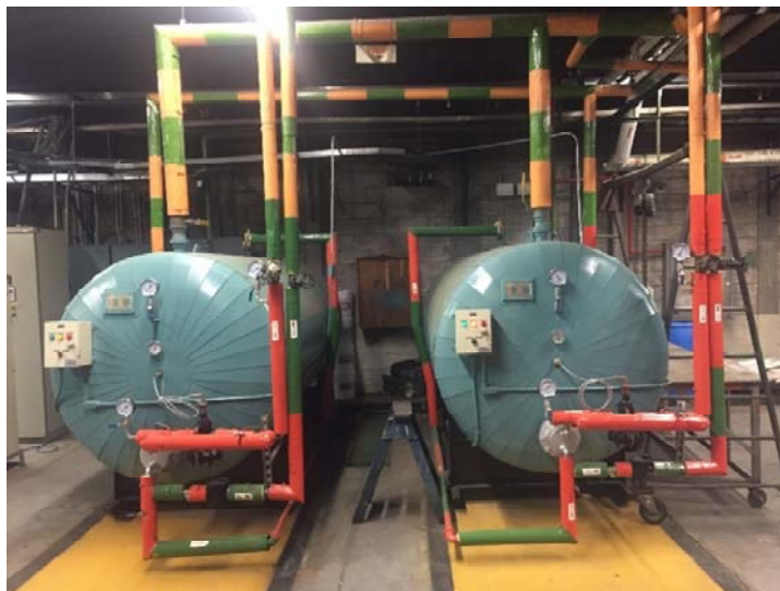
Figura 1.6 Sistema de calentamiento de agua Torre Norte y Patrimonio Histórico.
