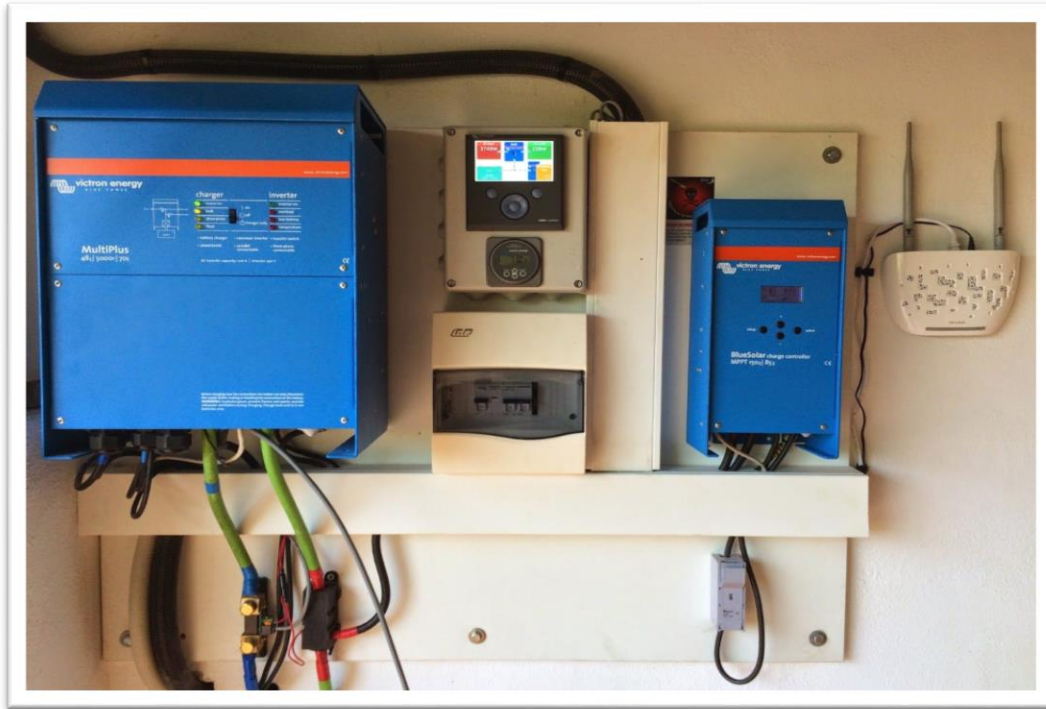
Figura 2.9. Ejemplo de una unidad de control o regulador para un sistema fotovoltaico industrial.
