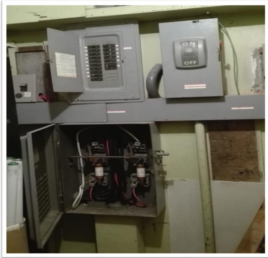
Figura 6.12. Centro de carga principal de la Escuela República del Perú.
