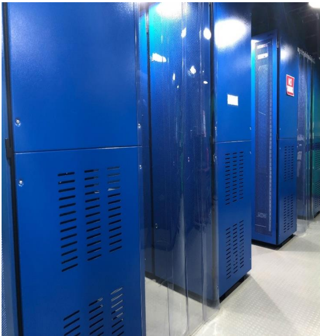
Figura 33 Ejemplo #1 de Racks para Servidores
