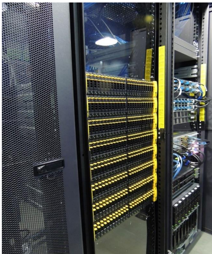
Figura 34 Ejemplo #2 de Rack para Servidores
