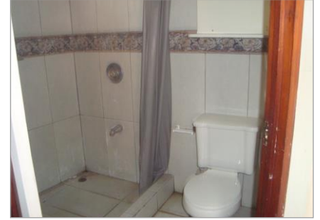
Baño en dormitorio de servicio
