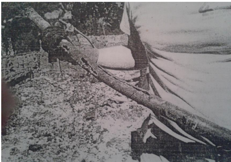
Figura 10-33: Conducto de mástil de servicio implicado en un incendio lo que muestra un arco y la penetración desde dentro. Aquí la corriente estaría limitada por la línea del transformador ( de 2,000 – 3000 A). Courtesy of E. R. Baker, Fire Investigator, Fresno, CA.
