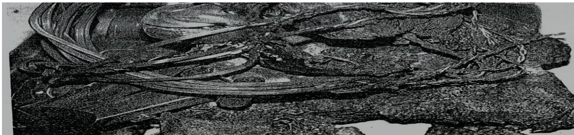
Figura 10-56: Una aspiradora fue la causa de un incendio en un armario, pero una revisión demostró que no estaba conectada a la hora del incendio. Los análisis del laboratorio confirmaron que la bolsa (que estaba destruida completamente) contenía polvo de piso lijado. El polvo lijado auto calentó la aspiradora y la encendió. Courtesy of Investigator Jeff Weber, San José, CA, Fire Dept.
