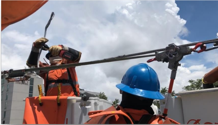
Ilustración 38. Implementación de la herramienta de corte y compresión por primera vez en labores reales
