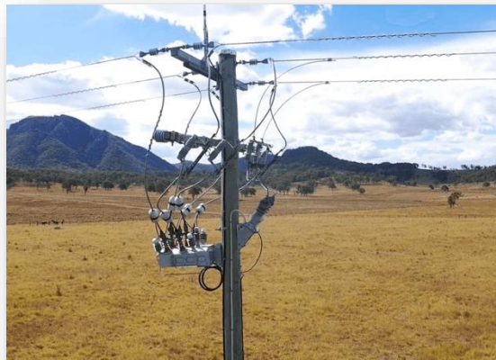
Ilustración 2. Líneas aéreas de media tensión
