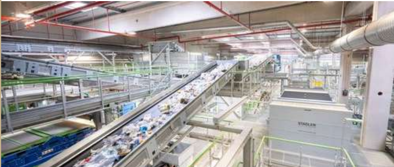
Figura C3. 07 Planta de tratamiento de residuos en Ibiza. Stadler Anlagenbau GmbH
