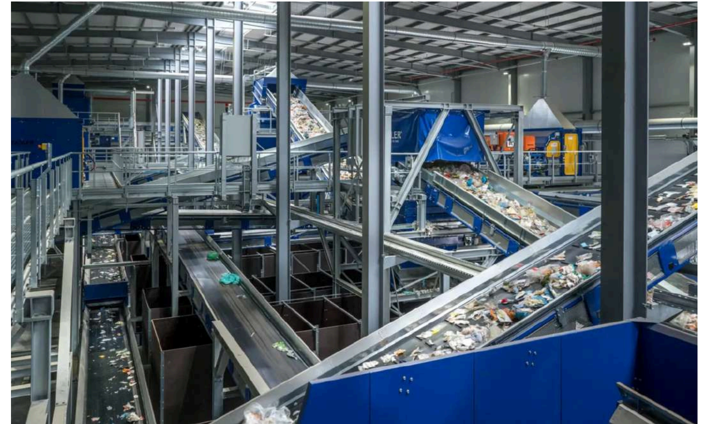
Figura C3. 24 Planta de tratamiento de residuos en Ibiza. Stadler Anlagenbau GmbH
