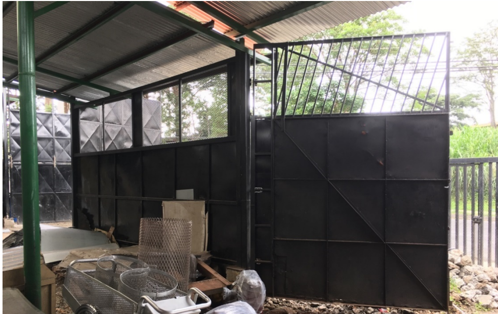
Figura 34. Ventilación Área de Producción
