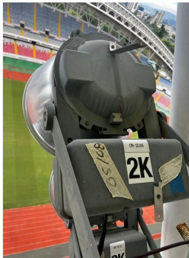
Imagen 25: Tipo de luminaria instalada para la iluminación de la gramilla.
