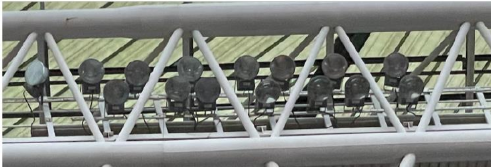
Imagen 33: El ajuste o realineamiento de la mayoría de estas luminarias provocaría el bloqueo de las vigas de la estructura del techo.
